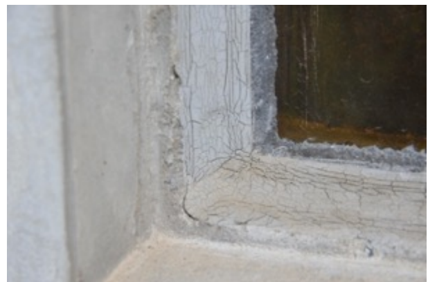
Fig. 44 : Joint d'étanchéité en silicone cassant et craquelé.
