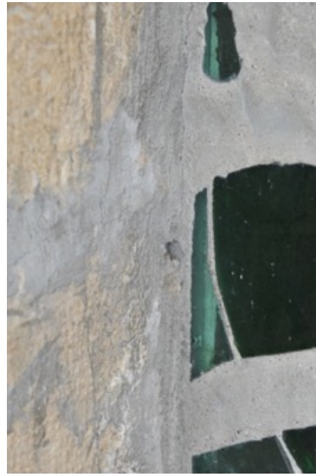
Fig. 45 : Fissure et perte dans le mortier de jointure.
