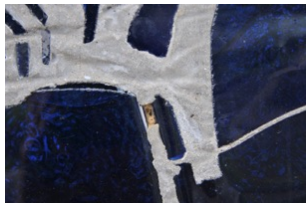
Fig. 47 : Nid d'insecte dans une lacune dans le joint entre deux verres.
