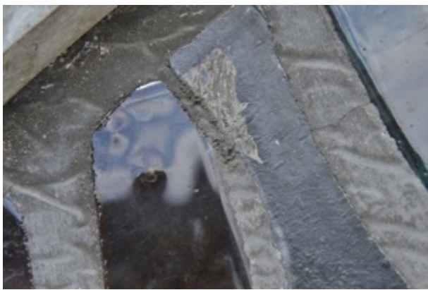
Fig. 55 : Lacune colmatée avec un mortier au ciment.
