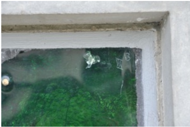
Fig. 48 : Dégât superficiel par impact mécanique.
