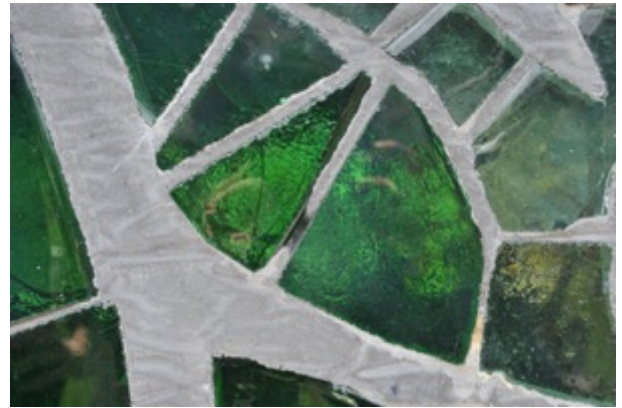
Fig. 54 : Joint partiellement remplis.
