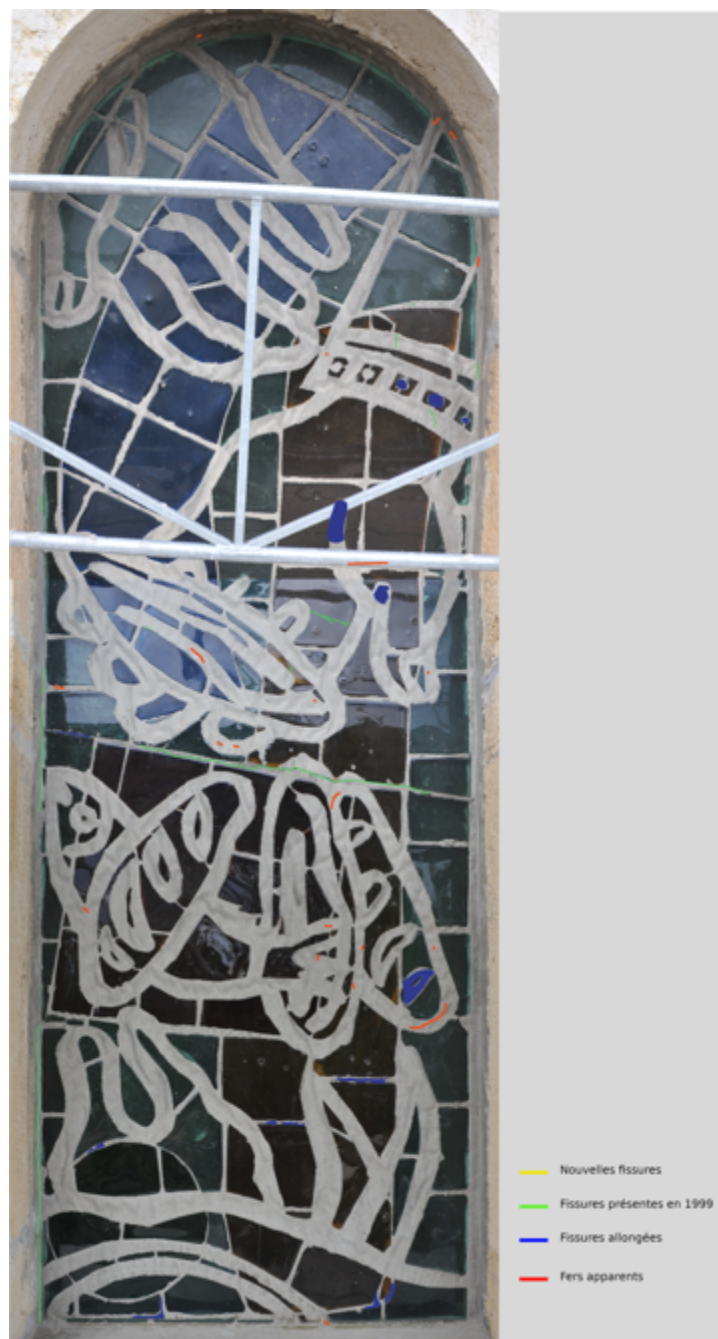
Fig. 84 : Relevé des dommages sur la Multiplication des pains .
