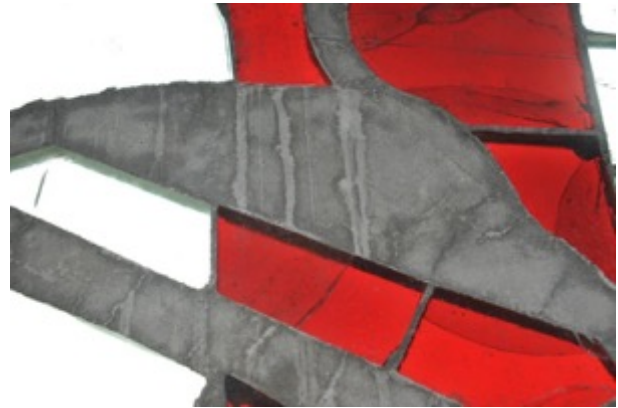
Fig. 49 : Traces d'eau sur la face interne de la Résurrection.
