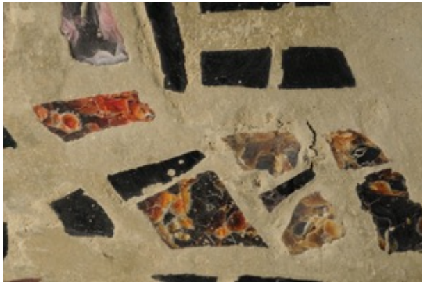
Fig. 34 : Écaillage du mortier autour de verres altérés.
