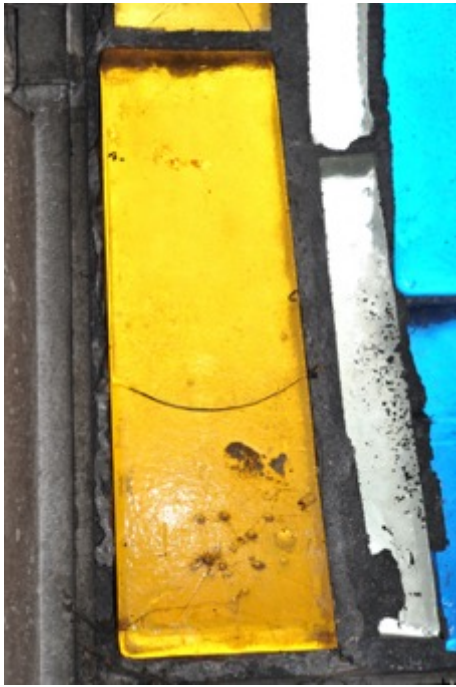
Fig. 42 : Verre fissuré (ouvrant).
