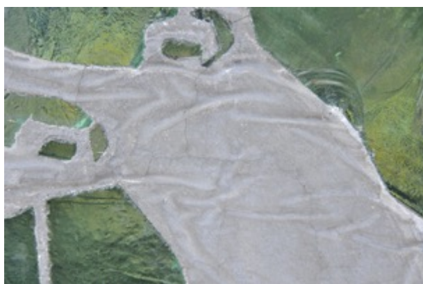
Fig. 38 : Réseau de fissures fines dans le béton.
