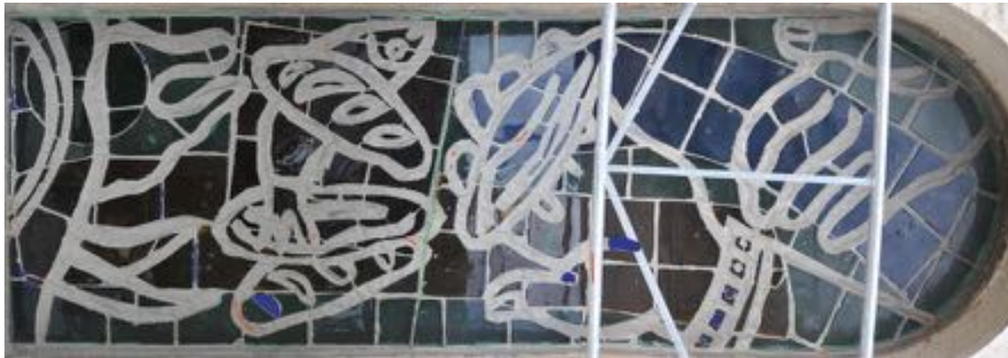
Abbildung 45: La multiplication des pains, Ergebnisse Risskartierung, feine Risse=grün, Offene (durchgehende?) Risse = braun, offenliegende Bewehrungsstäbe=rot, ursprüngliche Betonhaut vorhanden= blau
