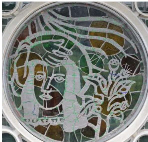
Abbildung 47: L'annonciation, Ergebnisse Risskartierung, feine Risse=grün, grössere Risse= blau, offene (durchgehende?) Risse = braun, offenliegende Bewehrungsstäbe=rot
