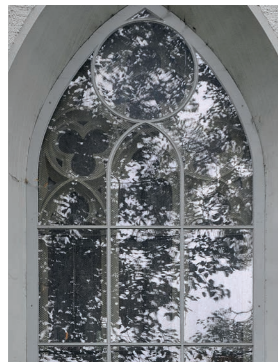
Contre-fenêtre avec cadre en bois subdivisé en croisillons, simple vitrage légèrement ventilé du chœur de l'église Saint-Laurent à Frauenfeld-Oberkirch (TG), env. 1900.
