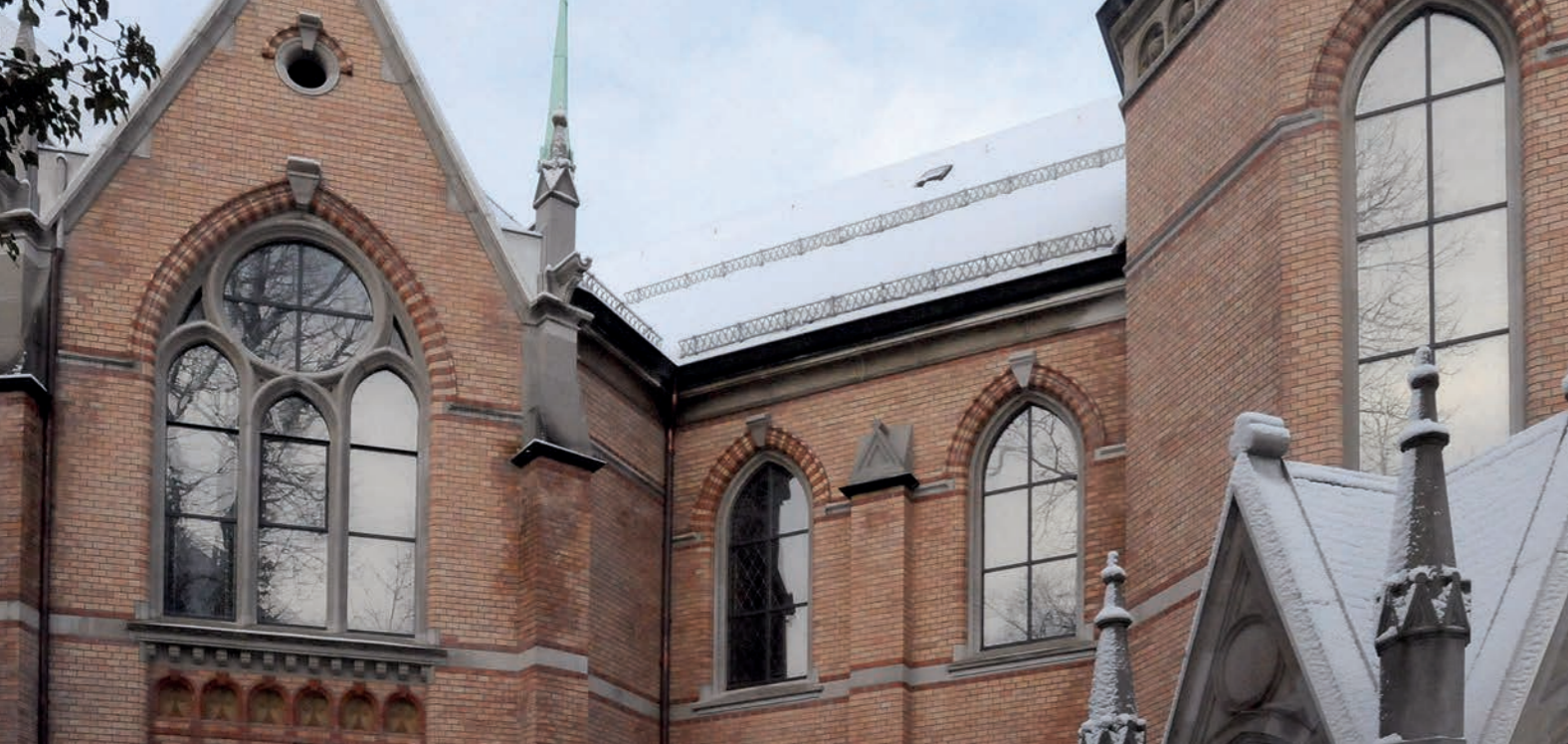
Système non ventilé avec vitrage isolant dans l'église de Bühl à Zurich (ZH).
