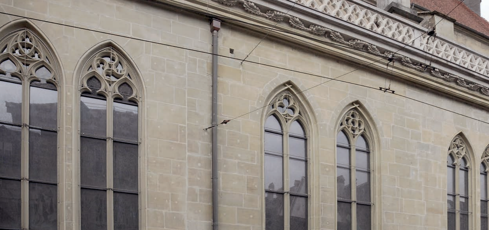
Verrière de protection avec double vitrage isolant, ventilée de l'intérieur, de la cathédrale Saint-Nicolas à Fribourg (FR). Photo : Stefan Trümpler, Romont.
